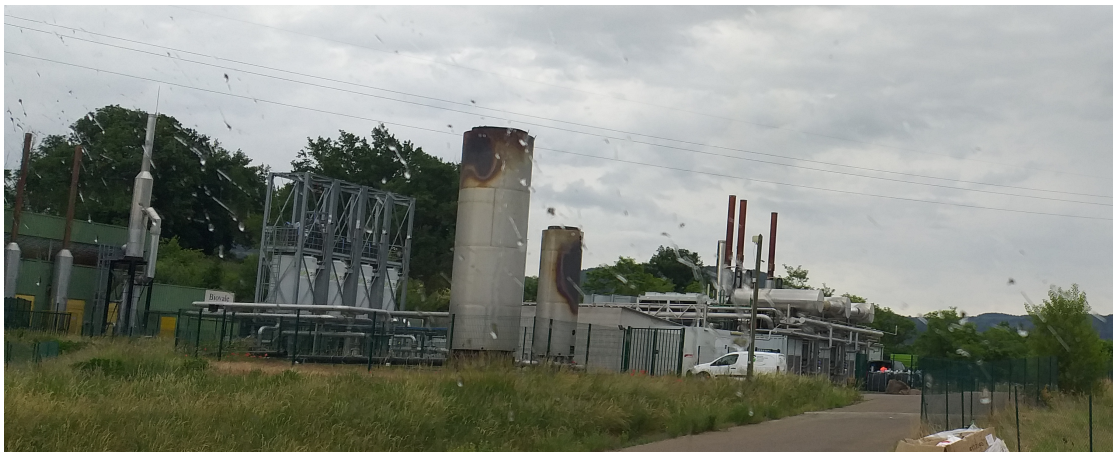
Centrale électrique au biogaz
